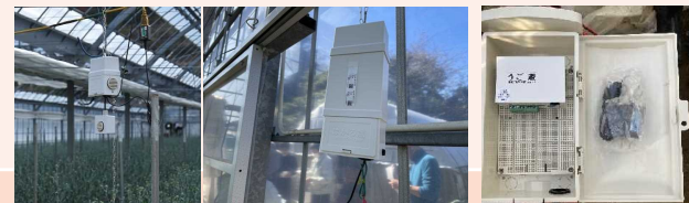
環境モニタリング装置と制御装置
