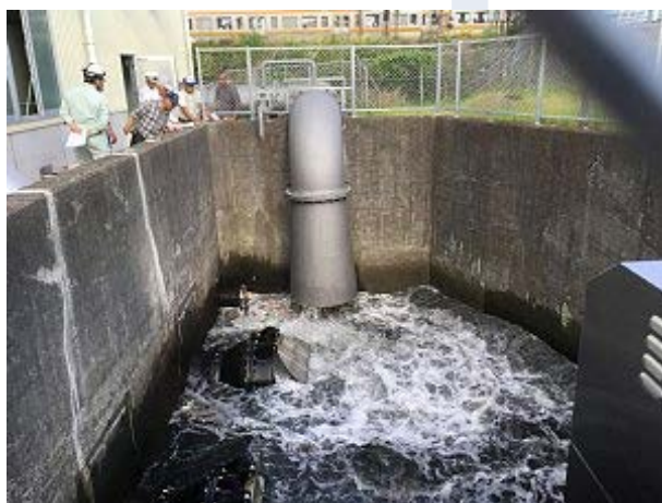
運転中の吐水槽
