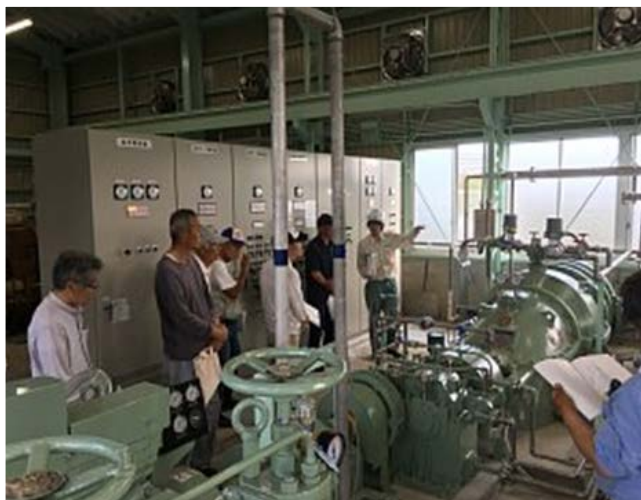
更新したポンプと配電盤の説明
