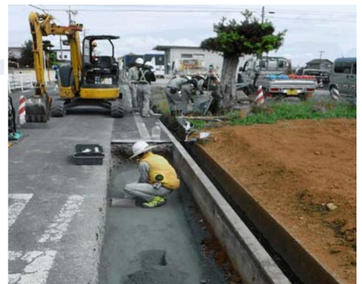
三方原用水の根洗用水路における新しい農業用水管の埋設工事
