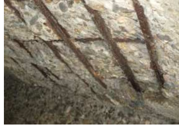
剥離・鉄筋露出（コンクリート橋）
