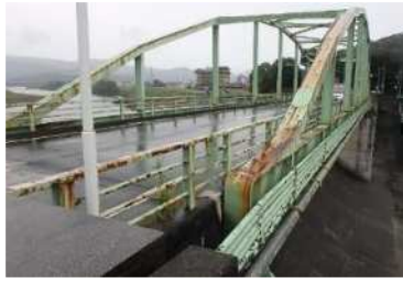
塗装の劣化（鋼橋）
