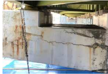
ひび割れ（下部工）
