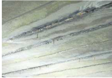
漏水・遊離石灰（コンクリート橋）
