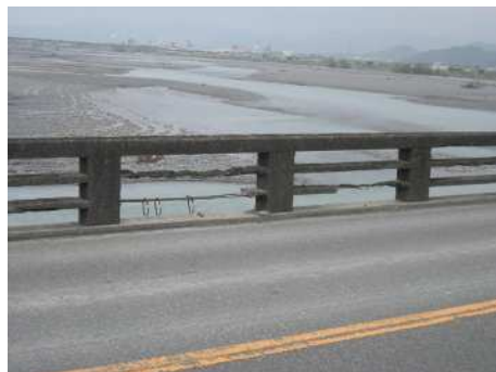
図-7.5 高欄部材の欠損
