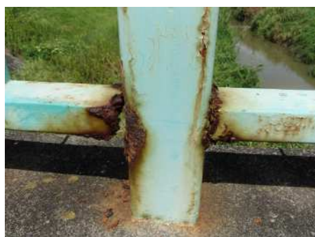
図-7.6 高欄の著しい腐食
