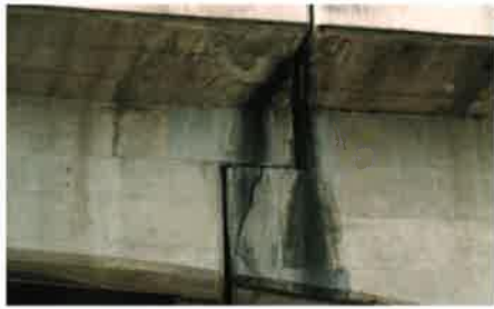
RCT 桁橋のゲルバー部 支点部の受け側に発生したせん断ひびわれ
