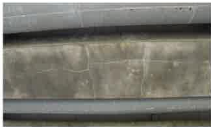
主桁下面に生じたひびわれ
