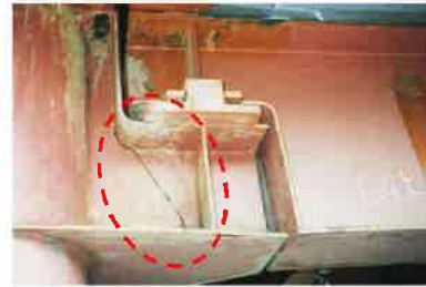
主桁ウェブのき裂
