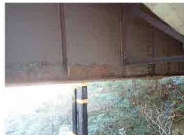
主桁ウェブの腐食 湿潤環境である
