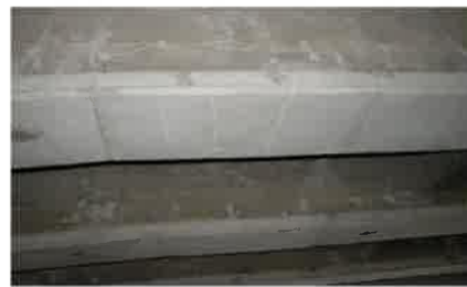
補強材に生じたひびわれ
