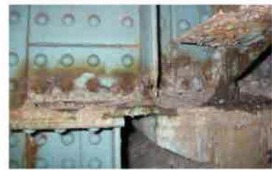
受け梁の腐食
