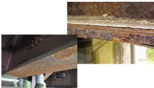
主桁下フランジの層状剥離（桁端部） 伸縮装置からの水の影響による
