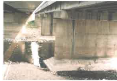
フーチング周辺が洗掘されている。
