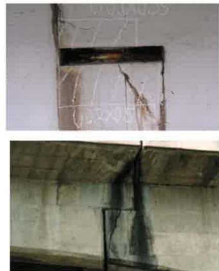
受け梁のひびわれと漏水跡
