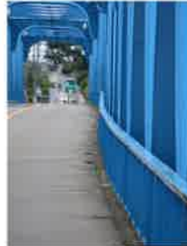
高欄や地覆の通りがずれている。
