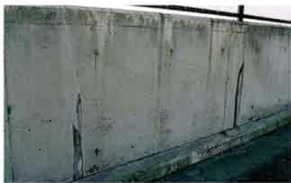
剛性防護柵に生じたひびわれ
