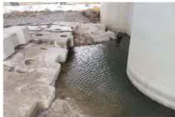
洗掘により橋脚周辺の河床材料が消失している。
