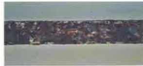
腐食度：C（グレード：F：IV）
