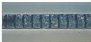
腐食度：腐食なし（グレード：F：I）
