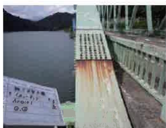
写真-2 連結板周辺の腐食事例
