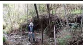
上流荒廃状況
