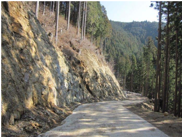
⑨3工区 岩法面風化状況
