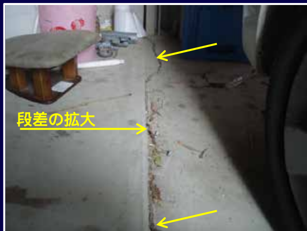
コンクリート叩きが発生したクラック
