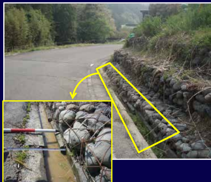
ふとんかごのせり出しで側溝が破損
