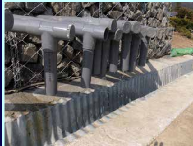
写真-2 集水(排水)状況
