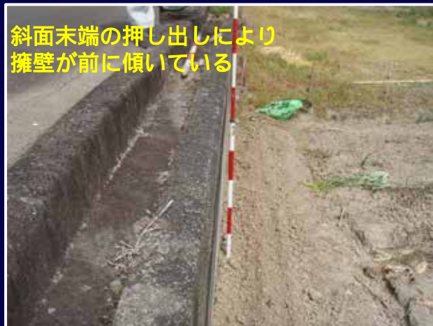
斜面末端のコンクリート擁壁が傾く
