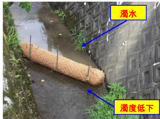
簡易濁水処理装置設置状況
