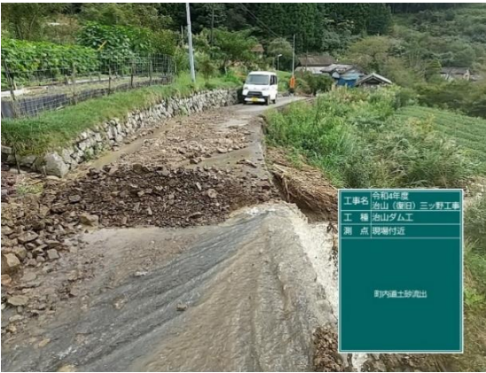
【地域貢献】災害関連 (台風15号による生活道への土砂流出状況)
