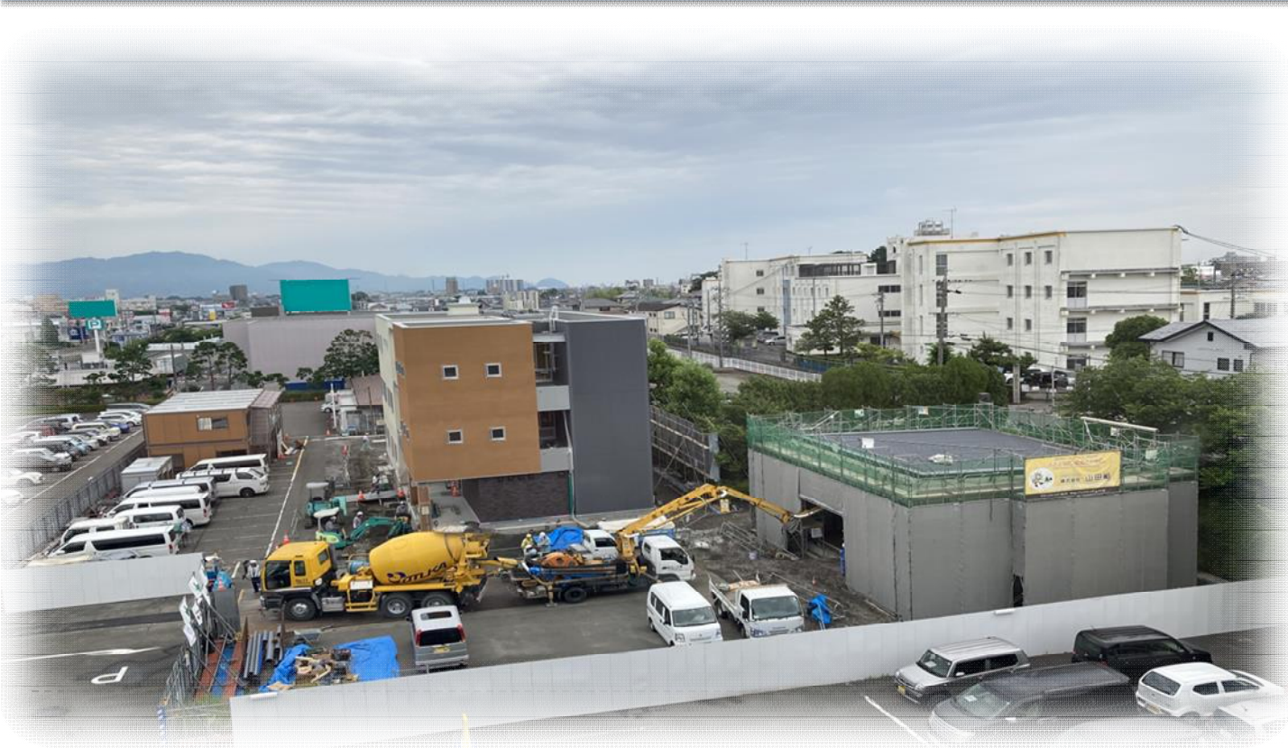
施工状況(左の建物が事務所、足場で囲まれているのは車庫)
