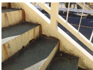
階段部地覆の腐食
