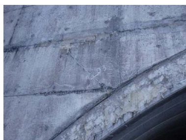
カルバートウイングのひび割れ
