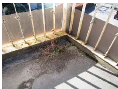
排水施設の土砂詰まり
