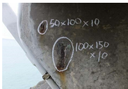
シェッド上部工の鉄筋露出
