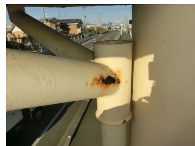
排水管の腐食
