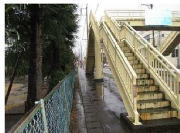
図-7.7 下部工により歩道幅員が確保できていない例
