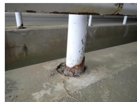
写真-7.5 防護柵支柱の腐食
