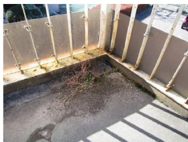
排水施設の土砂詰まり
