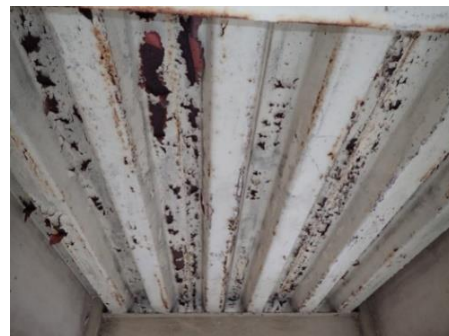
写真-7.3 塗膜の剥落
