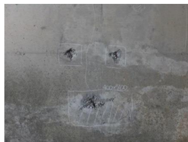
大型カルバート 剥離・鉄筋露出
