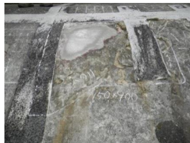
シェッド 主梁補修材のうき
