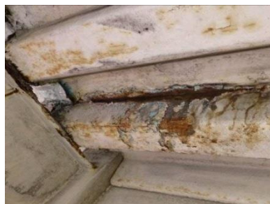
横断歩道橋 床版の腐食
