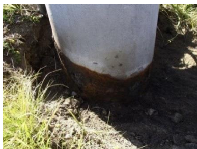
門型標識 地面境界部支柱の腐食
