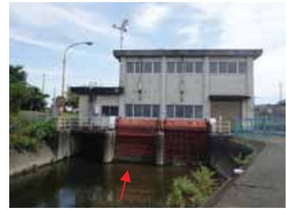
図 1-22 榛原第一排水機場
