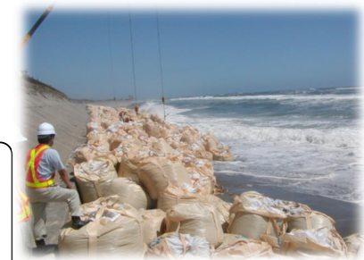
写真 新居海岸の侵食状況 (2002 (H14) 年)
