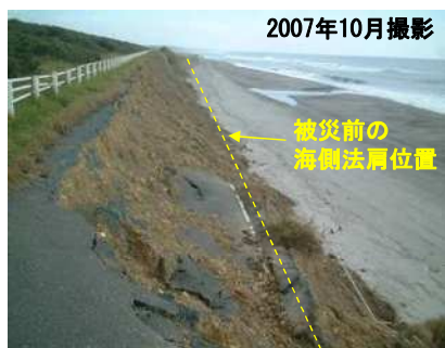
2007年7月の台風第4号による 堤防上自転車道の被災状況
