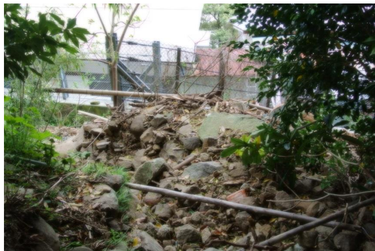
がけ崩れ発生直後 (H29.4.21)
