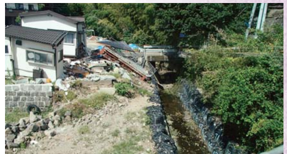
熊本県益城町被災状況車窓にて視察
