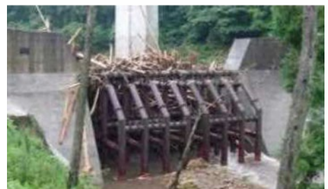
流木捕捉効果の高い砂防堰堤の設置
