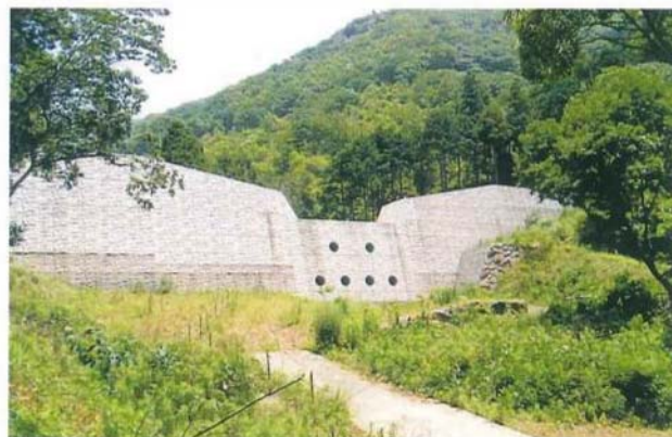
沢梅川砂防堰堤
