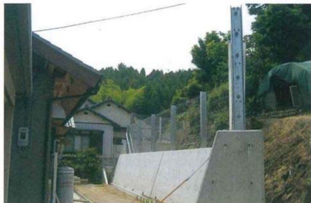
整備が進む池田地区急傾斜地崩壊防止施設
