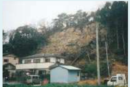
往還急傾斜地(宮城県内)浅部風化岩の崩壊
