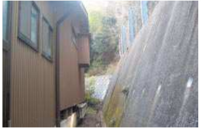
山の根急傾斜地崩壊危険区域
