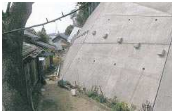
勝佐急傾斜崩壊危険区域
