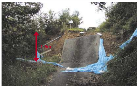
地すべりにより市道に発生した段差
