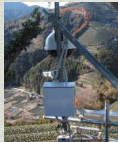
地すべり対岸の監視カメラ
