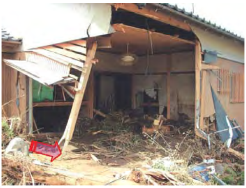
土石流により被災した住宅
