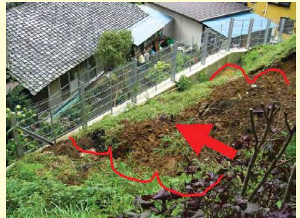
土砂崩壊の状況(斜面上部より)
