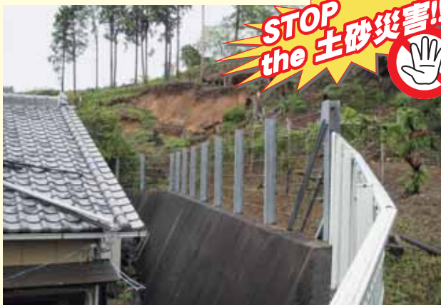
がけ崩れから人家を守った急傾斜施設（浜松市西区庄和町）
