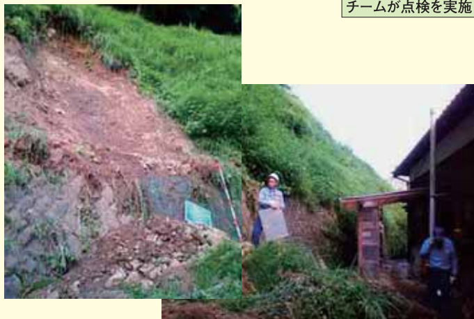
緊急点検Bランク箇所（伊豆市修善寺町堀切）
