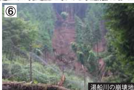
湯船川の崩壊地
