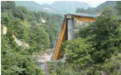
地震により破壊された祭時大橋
