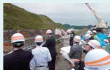
大規模地すべり現場
