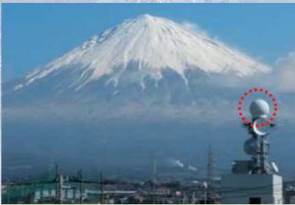
富士砂防事務所庁舎に設置しているXバンドレーダ
