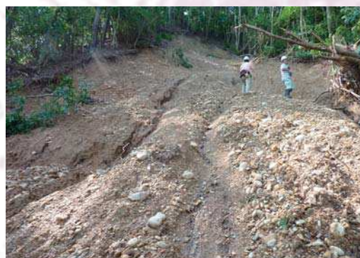
崩壊下部から上部を望む
