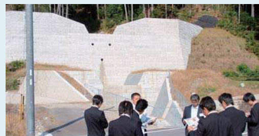
災害関連緊急砂防事業にて完成した堰堤(岐阜県八百津町)
