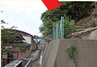
がけ崩れから幼稚園を守った急傾斜施設 (西伊豆町安良里)
