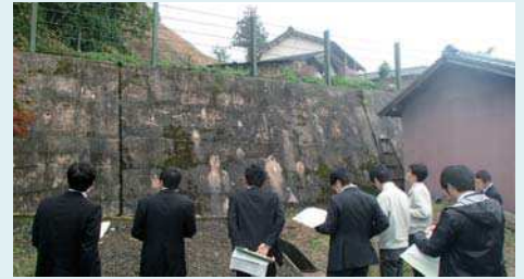
九久平区域 急傾斜地崩壊防止施設緊急改築事業 (愛知県豊田市九久平町)
