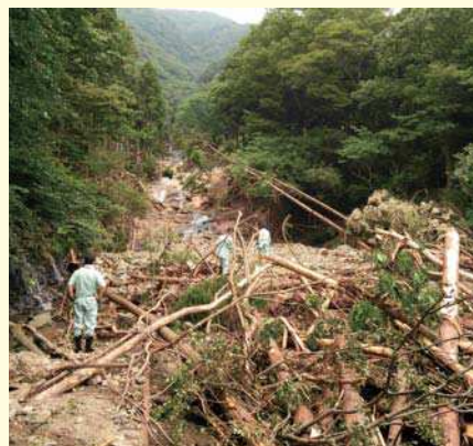
安良里浜川土石流被災状況 (西伊豆町安良里)
