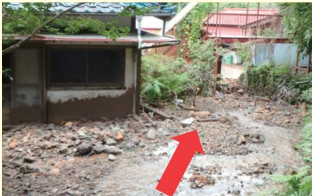
土石流(賀茂郡河津町大鍋)
