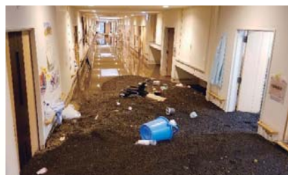
■台風19号による被災状況
