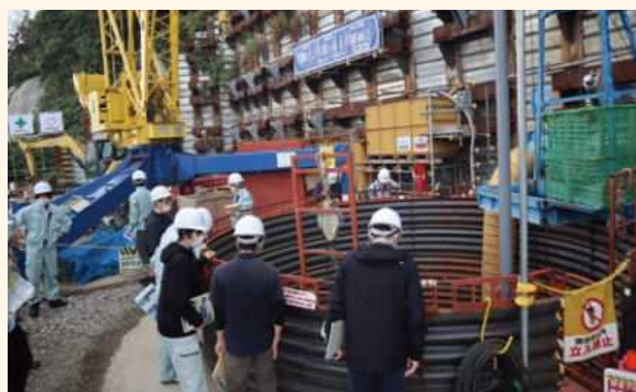
抑止杭の現場状況(由比地すべり)
