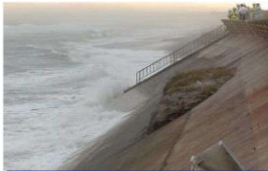
新居海岸の侵食状況
