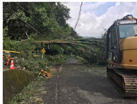
台風21号による被災状況 (H30.9.5撮影)
