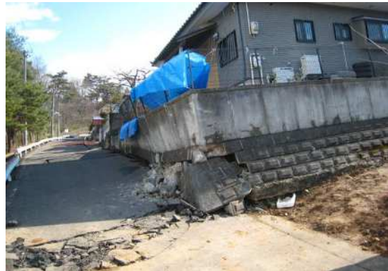
宅地造成盛土の崩壊事例 （2011 年東日本大震災の仙台市折立地区）
