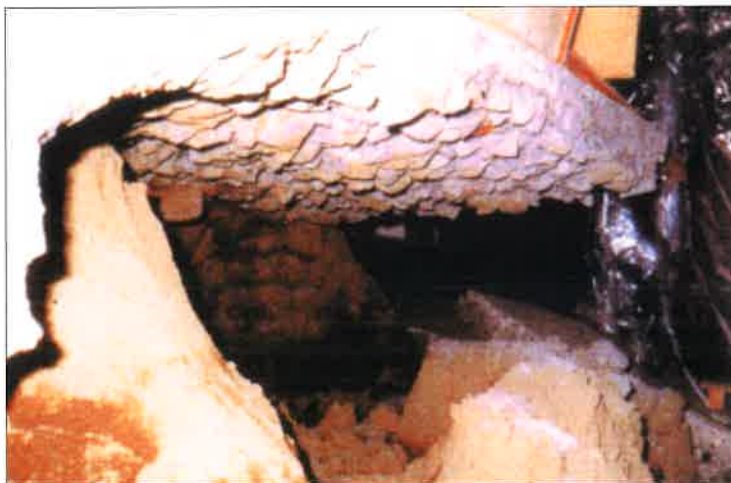
液状化現象で建物の基礎の下の地盤が流出
