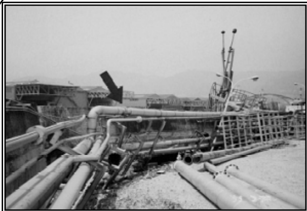
LPガス貯蔵設備の被害（阪神・淡路大震災） （兵庫県南部地震に伴うLPガス貯蔵設備ガス漏洩調査報告書より）
