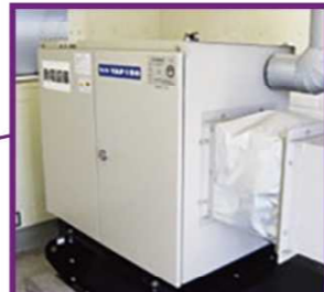
(図5) 自家発電装置
