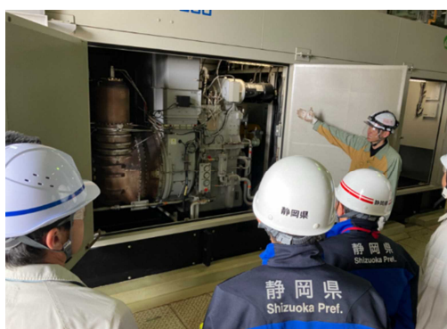
＜写真：ガスタービン発電機の確認の様子＞
