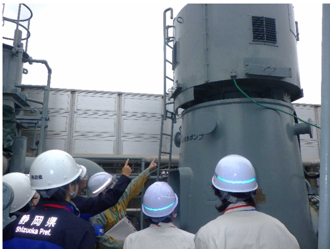
<写真：原子炉機器冷却海水ポンプの電動機を確認している様子>
