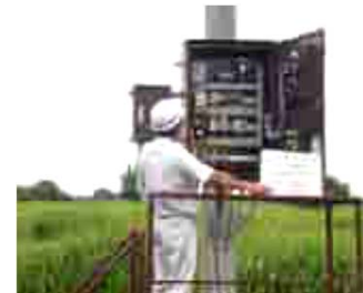
浸水した揚水機場の制御盤を交換することによりポンプ機能を回復
