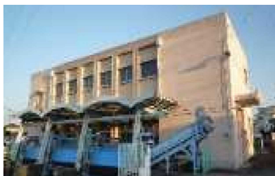
▲遠隔監視制御 袋井排水機場（袋井市）
