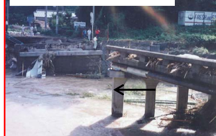
(国) 414号志戸橋の落橋状況
