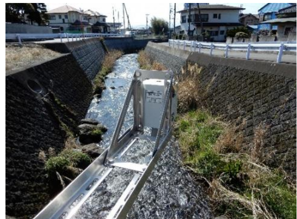
水防活動の充実（危機管理型水位計の設置）
