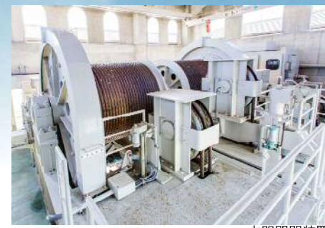
水門開閉装置
